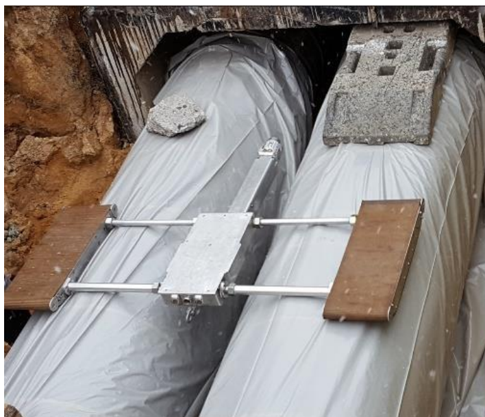
Figura 27 Ispezione visiva con il “Crawler Eye” dell’Institut für Angewandte Bauforschung Weimar gGmbH tedesco (Fonte: AGFW)
