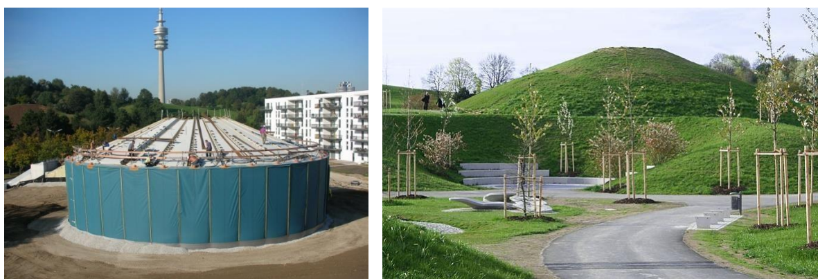
Figura 57: Serbatoio per lo stoccaggio dell'energia termica da 5.700 m 3 d'acqua costruito con elementi pre-fabbricati a Monaco, in Germania (in costruzione e terminato, Fonti: Solites)
