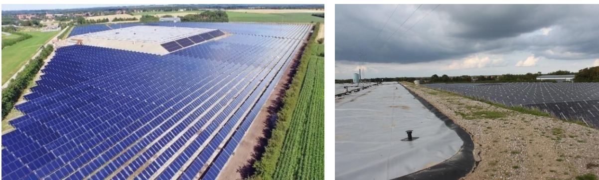
Figura 36: Campo di collettori solari a Gram, in Danimarca, con stoccaggio stagionale dell'energia termica sotterraneo (Fonti: sinistra: Gram Fjernwärme, destra: D. Rutz)
