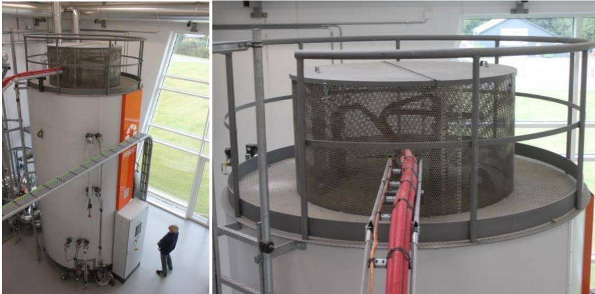
Figura 51: Caldaia a elettrodi da 10 MW e 14,4 m 3 di capacità, centrale di teleriscaldamento solare di Gram, in Danimarca (Fonte: D. Rutz)
