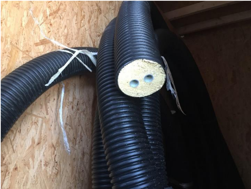
Slika 6: Nisko-temperaturni CTS omogućuje primjenu plastičnih cijevi (u ovom slučaju dvostruka pred-izolirana), koje su jeftinije i lakše za instalaciju (Izvor: B. Doračić)
