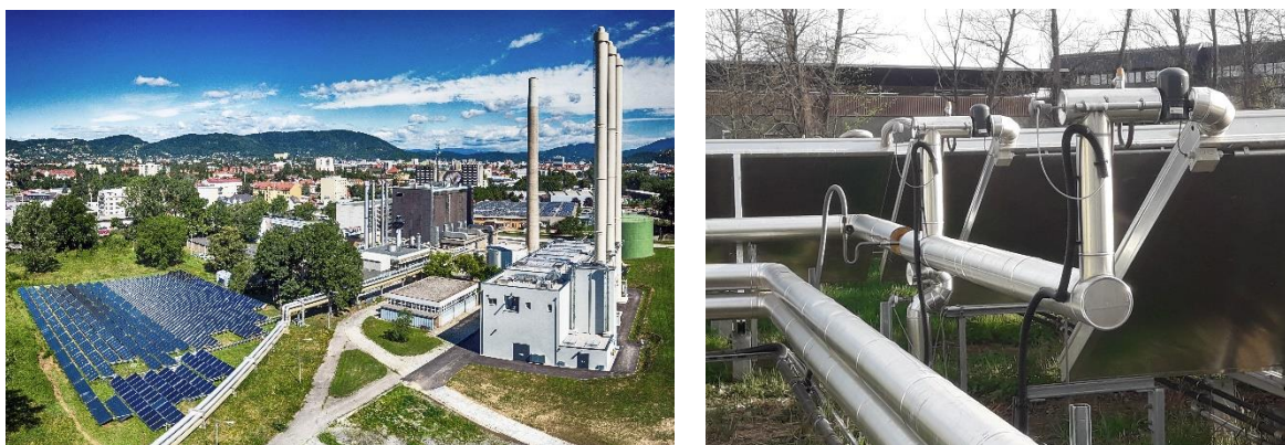
Slika 35: Polje solarnih kolektora spojenih na CTS, Graz, Austrija (Izvor: lijevo: SOLID; desno: D. Rutz)
