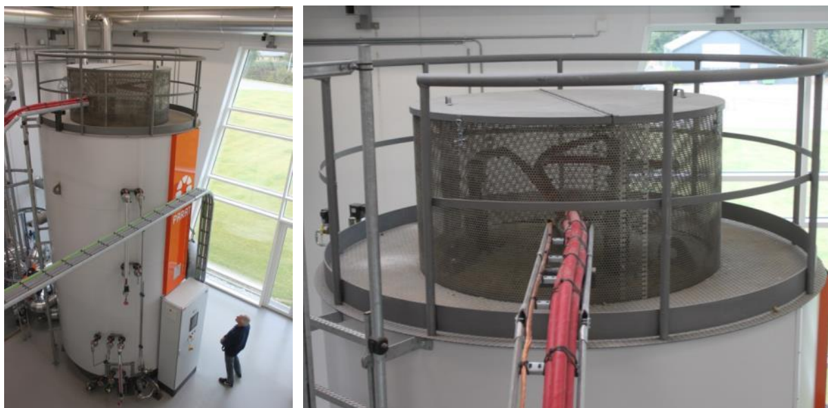
Rysunek 51: Kocioł elektrodowy o mocy 10MW i 14,4m 3 instalacji ciepła słonecznego w Gram, Dania (źródło: D. Rutz)
