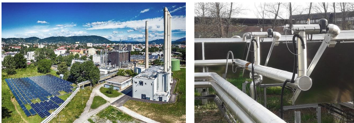
Rysunek 35: Pole kolektorów słonecznych w mieście Graz w Austrii, które zasila sieć ciepłownicza Graz (Źródła: lewe: SOLID; prawe: D. Rutz)
