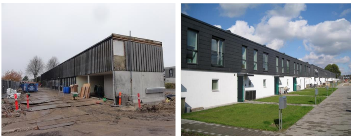
Rysunek 25: Budynki w Albertslund, Dania przed (po lewej) i po (po prawej) odnowieniu (Źródło: COWI)
